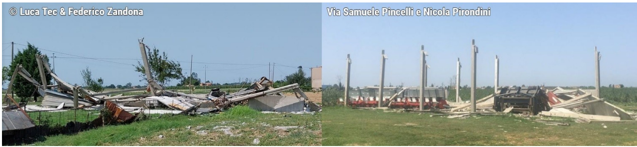
Fig. 32: Capannoni e infrastrutture agricole devastate tra Voltana e Alfonsine.
